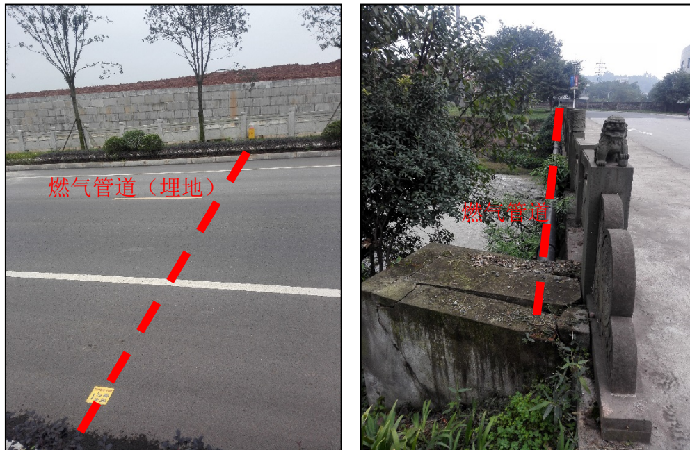
图 1-2 管道穿越园区道路、河流处
